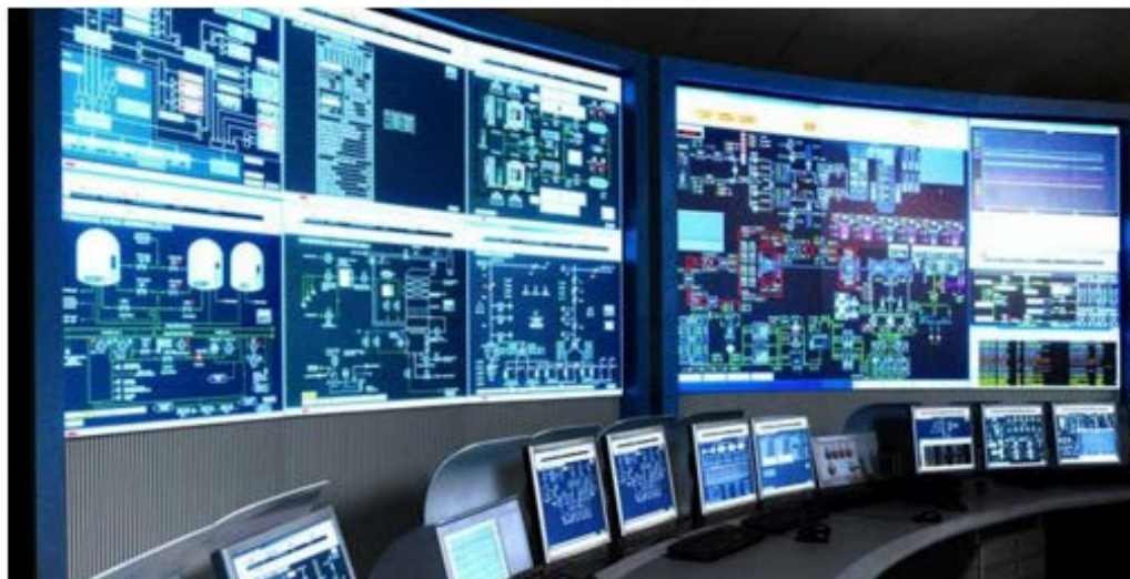
Figura 20: Monitoreo de redes eléctricas, agua, hidrocarburos mediante sistemas SCADA
